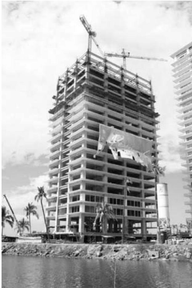
Imagen 11. Construcciones de edificios de uso mixto en zonas de alto riesgo como el río Pitillal
