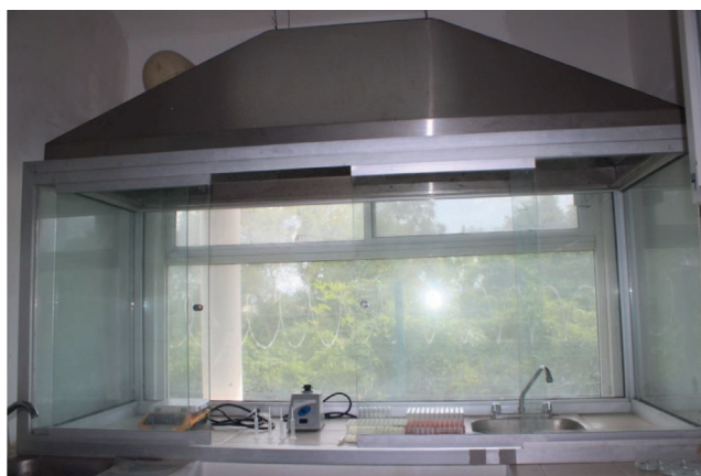
Fig. 81. Campana de extracción de gases para trabajo con materiales peligrosos.
